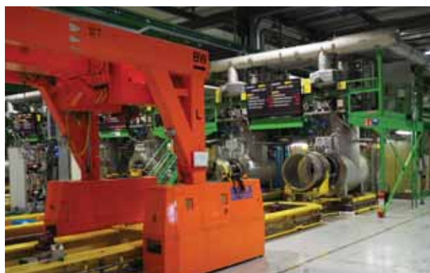
Fot. 3. Wyposażenie hali testowania urządzeń kriogenicznych.
